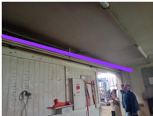
Passage refoulement dans Ateliers
