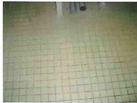
P 4: Bâtiment vestiaires-sanitaires - RDC - casiers voilerie - colle carrelage - Photo n° 4
