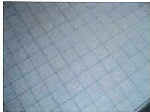
P 2: Bâtiment vestiaires-sanitaires - RDC - casiers voilerie - colle carrelage - Photo n° 2
